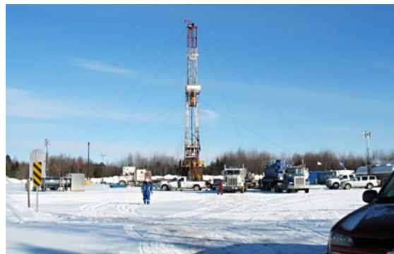
Le Ministère a trouvé 11 cas de «migration de gaz» sur les 31 puits de gaz de schiste que compte le Québec. Celui de Leclercville en faisait partie.
